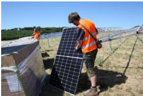
Kontrolle der Solarmodule auf Beschädigungen.
